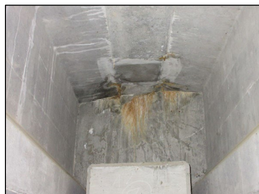
析出物、漏水跡（間詰コンクリート）
