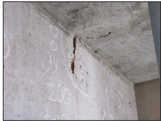
欠損、鉄筋露出
