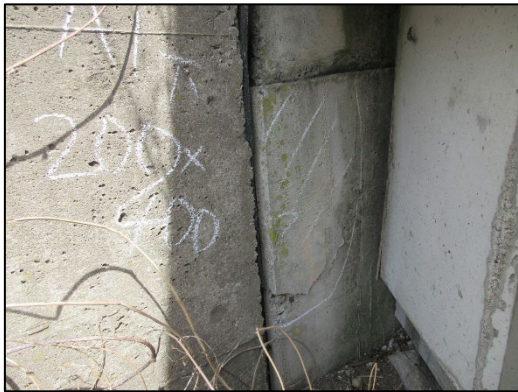
ひび割れ、浮き
