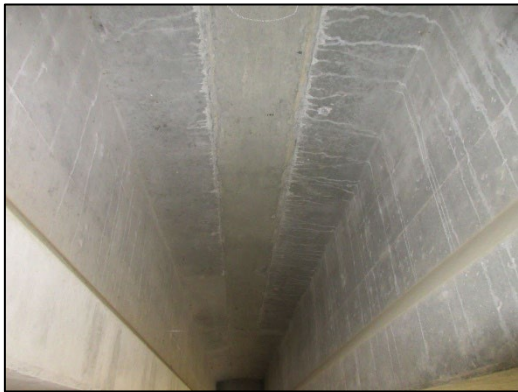
析出物（間詰コンクリート）
