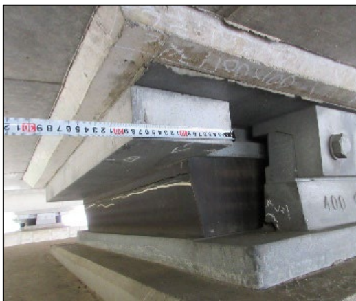
ゴム支承の亀裂
