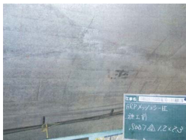
施工前（うき・はく離）
