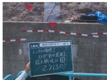
施工前（ひび割れ）
