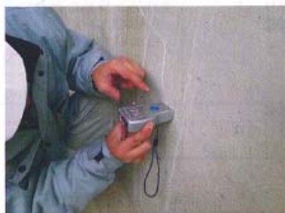
ひび割れ幅測定状況
