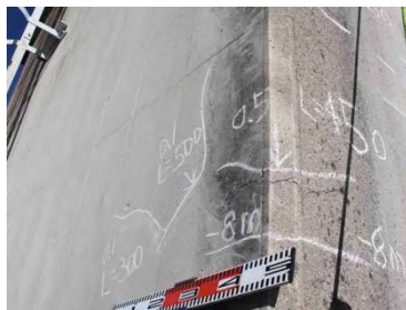
橋脚角部に生じたひびわれ
