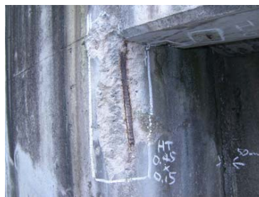
橋台鉄筋露出
