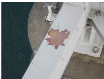
下構塗装劣化
