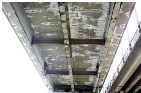
←主桁の腐食状況
