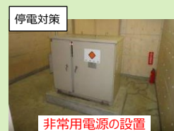
非常用電源の設置
