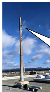
LPWA 基地局 (袋井市役所屋上)
