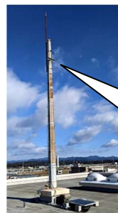
LPWA 基地局 (袋井市役所屋上)
