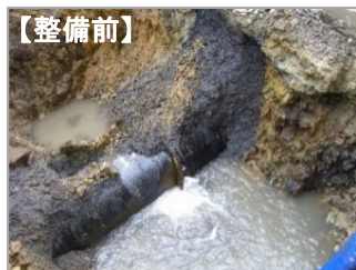
パイプラインの漏水
