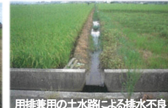
用排兼用の土水路による排水不良
