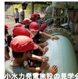
小水力発電施設の見学会
