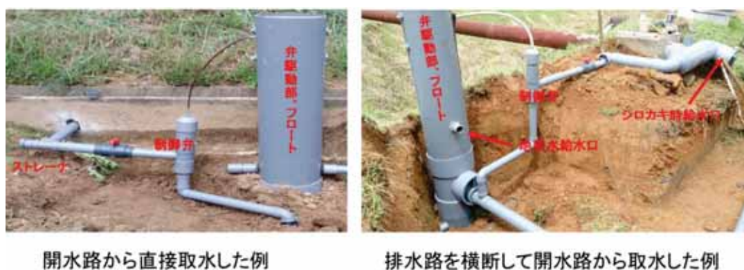
図 1-3 独自開発弁を利用した無電源制御装置
