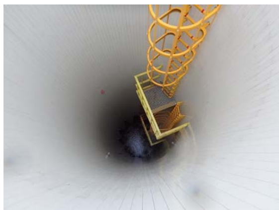
図 1-6-8-11 施工後 1 年の状況
