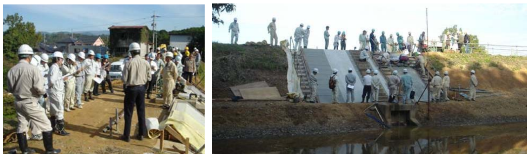
写真-11 施工見学会の状況（左：堤体上での説明、右：施工状況の見学）
