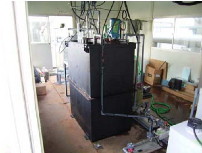
写真-4-4 間欠ばっ気活性汚泥装置の外観
