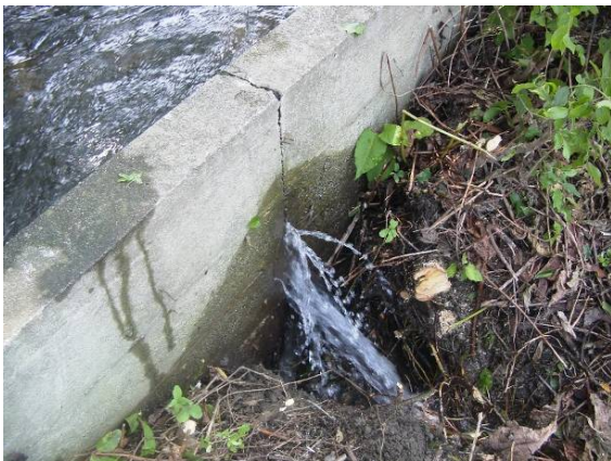
写真－1 目地部からの漏水
