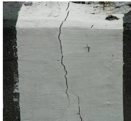
写真－2 目地補修部の再ひび割れ
