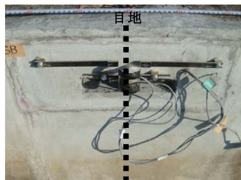
写真-12 9ヶ月経過後の目地部表面
