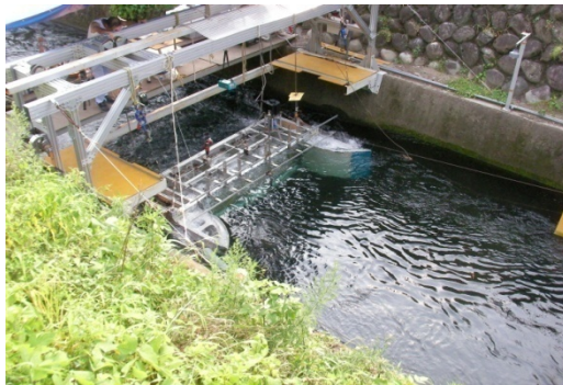
図3 水車設置状況
