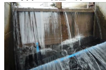
写真-7 傾斜板の流
