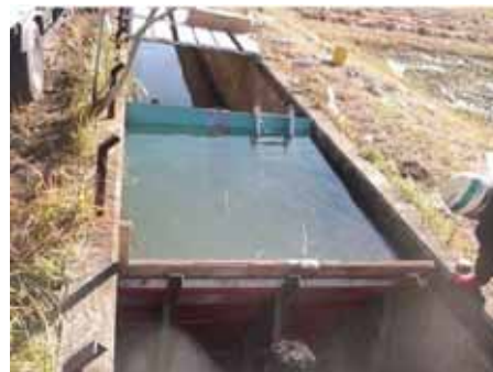
図-2.1.2 区間締切装置設置状況
