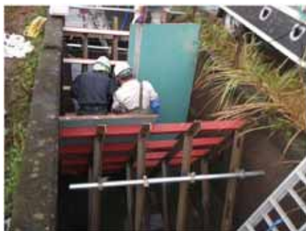
図-1.6.2 区間締切装置設置状況
