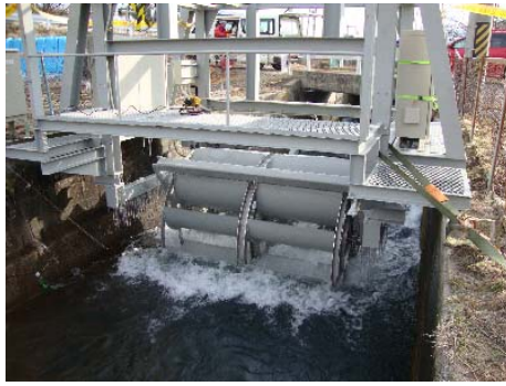
図-3:2連結水車 連続運転状況
