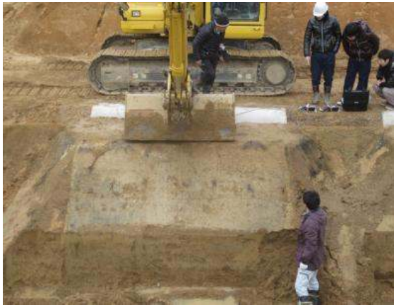
写真-6 現場せん断状況
