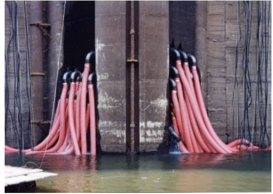
【水中ポンプによる揚水の様子】
