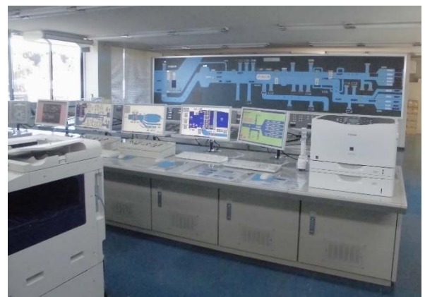
【遠方集中監視手動制御施設】
