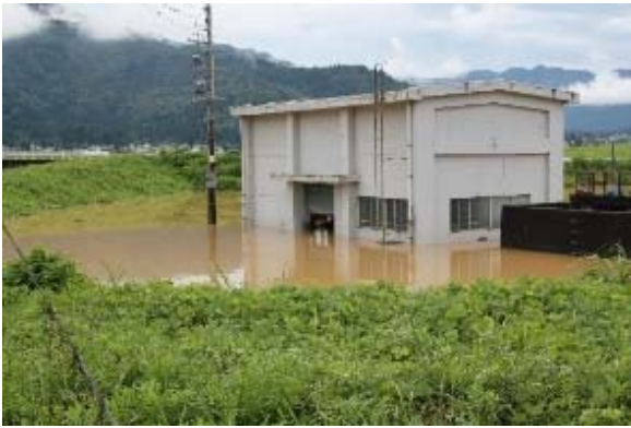
平成 23 年 7 月の豪雨で、ポンプの動力となる電気系統が水没し、使用できなくなりました。
