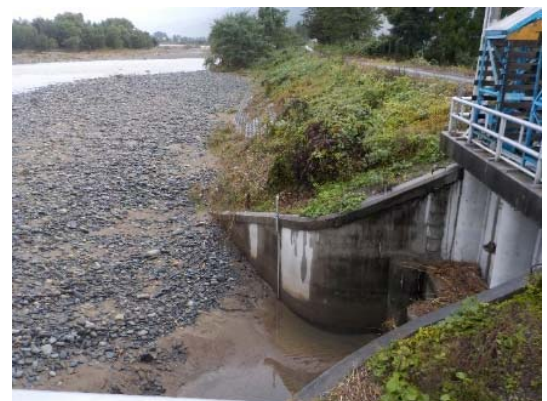
土砂で埋まってしまった魚野川頭首工の土砂吐。撤去に 20 日間かかりました。
