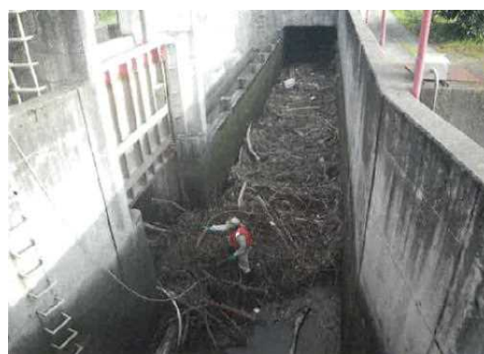
豪雨後の水路
