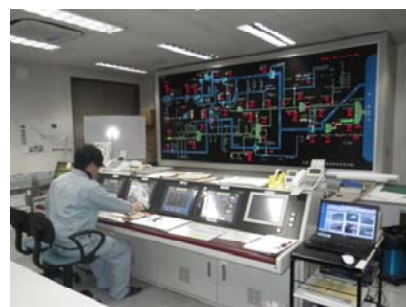
中央管理所でのポンプ運転・調整
