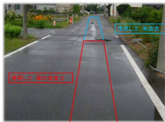
写真 5-2-1 中越沖地震時の再被災状況（固化改良土埋戻し工法を採用した区間（写真手前）には路面沈下は見られないが、当該工法の未採用区間（写真奥）には路面沈下が見られる。）
