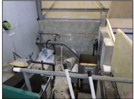
写真2 原料投入室内部
