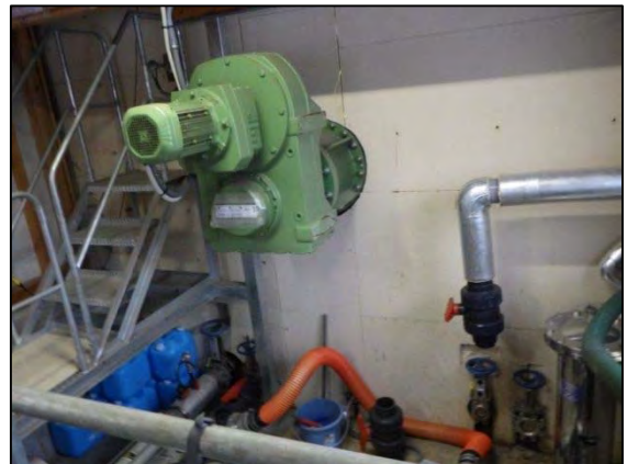
写真4 ポンプ室（横軸パドル式攪拌機：発酵槽）
