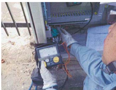
写真－５－４ 中継ポンプ制御盤の絶縁抵抗値測定
