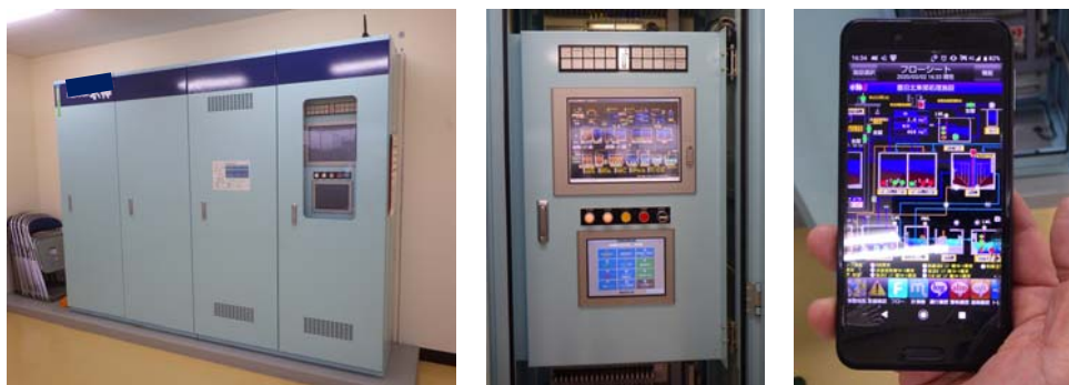
写真-6-10 汚水処理施設内の制御盤と遠方監視装置
