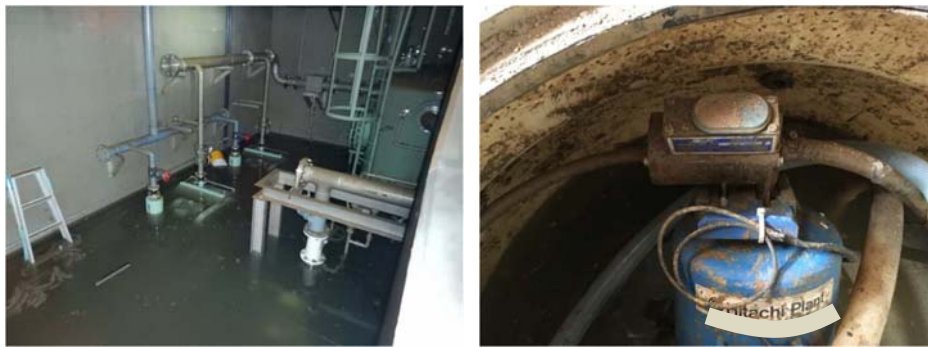
写真－４－７ 左：真空ステーション浸水状況、右：真空弁コントローラ浸水状況
