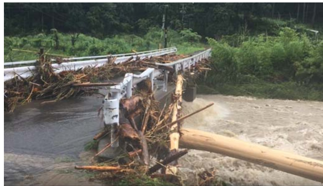
写真－３－１ 災害時の汚水処理施設へのアクセス橋梁の状況
