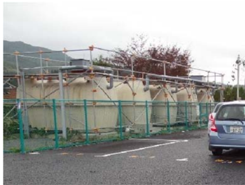
写真－４－５ 応急仮設住宅に設置される浄化槽（参考）
