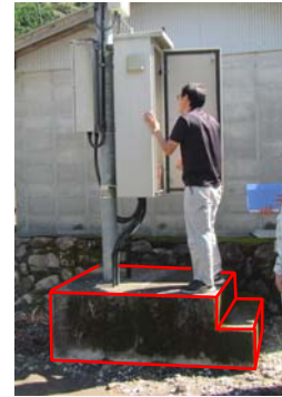
写真－６－１４ 制御盤の高所化
