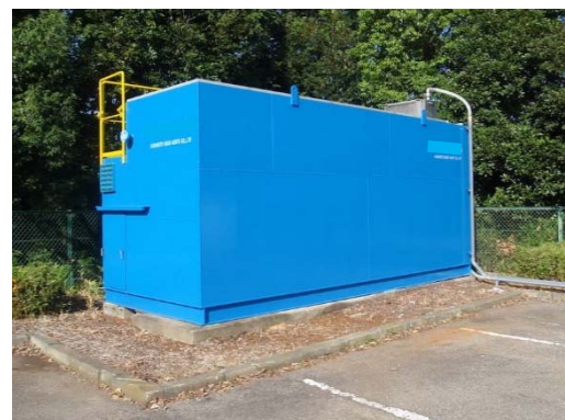
写真－４－３ ユニット型仮設処理施設
