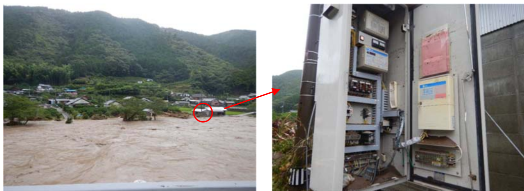
写真－６－２ 中継ポンプ制御盤の冠水
