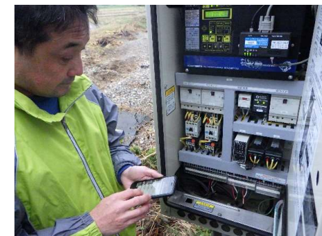
中継ポンプをスマートフォンで操作
