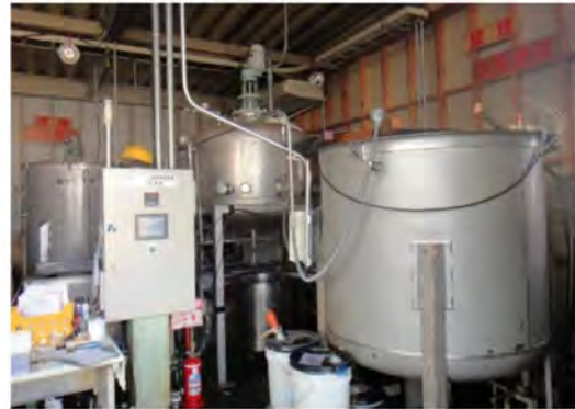
バイオ燃料生成プラント
