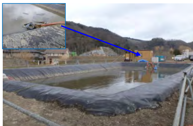
写真－４－８ 仮設沈殿池及び仮設塩素混和槽
