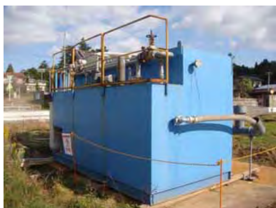
写真－４－７ ユニット型仮設污水处理施設
