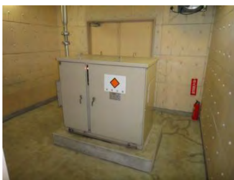
写真－６－１２ 非常用発電設備
