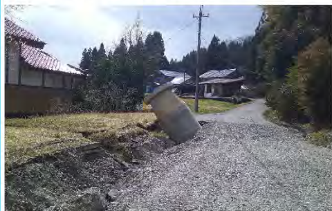
浮上したマンホール
