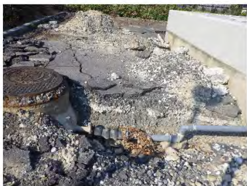
外構の被災状況
