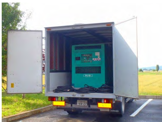
写真－４－４ 発電機搭載車
