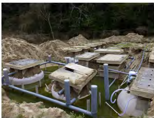
盛土崩壊の状況
