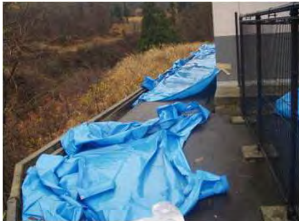
写真－３－６ 汚水処理施設周辺の崖崩れ保護
