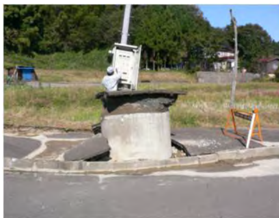
写真－３－２ 中継ポンプの緊急点検・調査状況 (中継ポンプの被災状況の調査)
