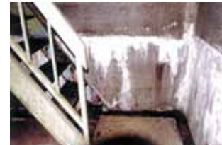
ポンプ室内コンクリート劣化
