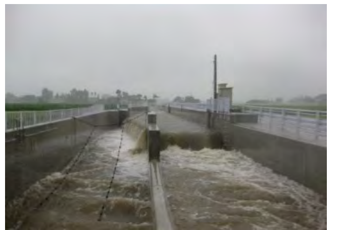
排水分水ゲート
