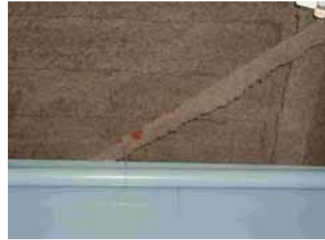
(天井への飛散性の吹き付け石綿の状況)
