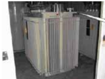
変圧器 配管フランジ部のパッキン及びバルブ軸部のシールガスケット
