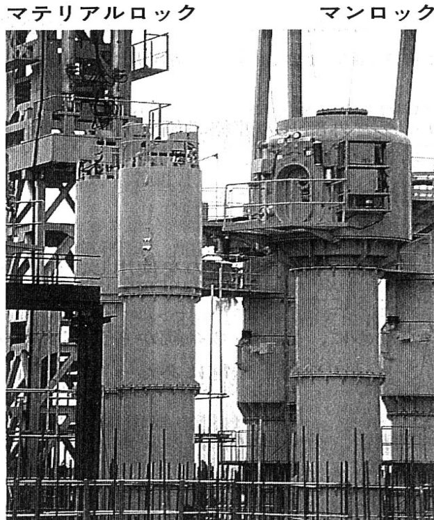
写真 24-1 マンロックとマテリアルロックの設置状況の例
