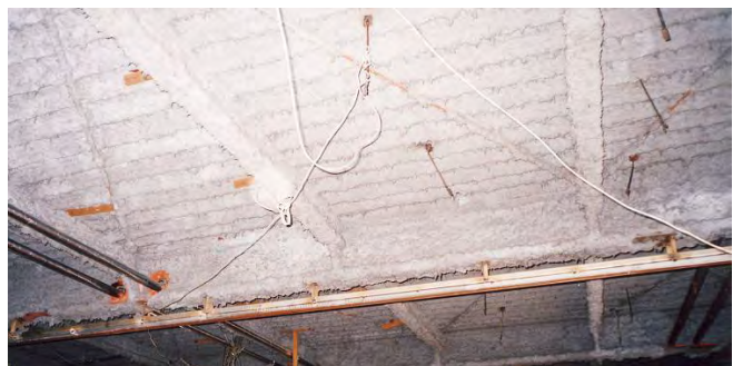
(天井への吹き付け石綿の劣化状況)
