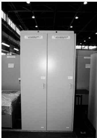
図 3.3-54 補助継電器盤外観例
