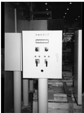
図 3.3-53 補機用機側操作盤外観例
