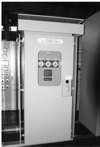
図 3.3-52 ゲート用機側操作盤(自立形)外観例
