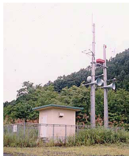
図 1.1-6 放流警報装置外観（例）
