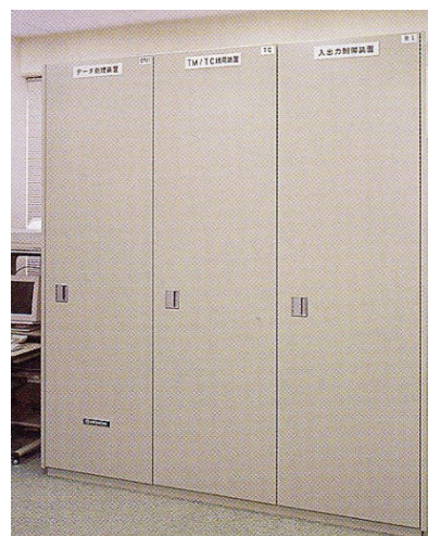
図 1.1-5 テレメータ・テレコントロール装置外観（例）
