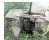
老朽化したゲート
