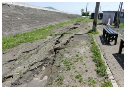
堤体の液状化
