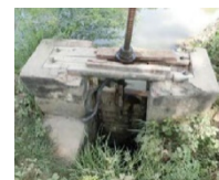
老朽化したゲート
