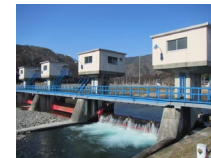
頭首工での越流による水膜振動等による音の発生
