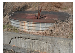
老朽化した集水井工の例
