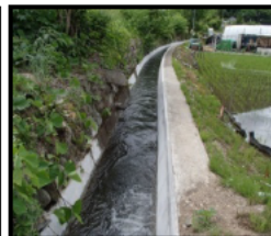
老朽化した用水路の整備・更新
