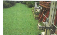
頭首工に繁茂した水草
