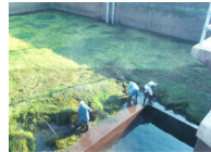
ファームポンドに繁茂した水草
