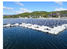
農業用ため池の水面に設置された太陽光発電設備
