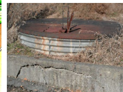
老朽化した集水井の例
