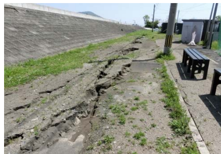
堤体の液状化
