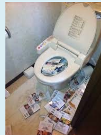
災害避難所のトイレ使用状況 (断水により衛生環境が悪化)
