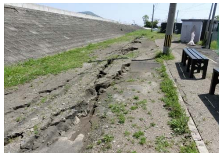
堤体の液状化
