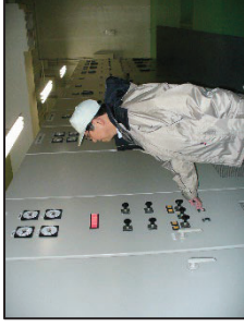
(ポンプの運転)
