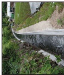
老朽化した用水路の整備・更新
